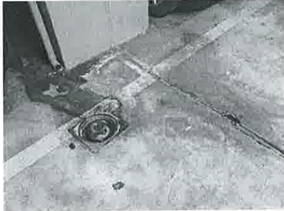
Estado del suelo y juntas de dilatación
