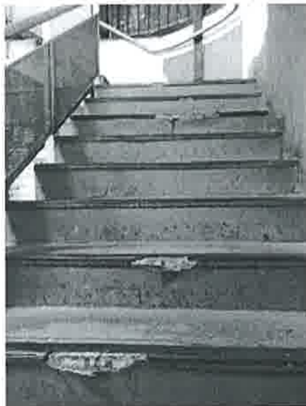
Estado de las escaleras
