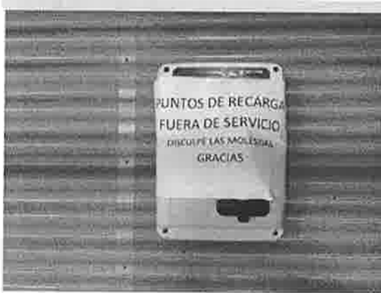
Puntos de recarga de vehículos (Parque Central)
