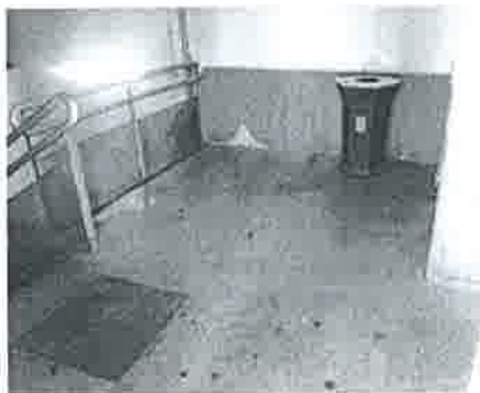
Estado del acceso al aparcamiento
