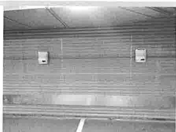
Puntos de recarga de vehículos (Parque Central)
