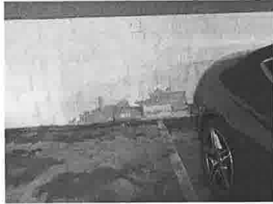
Estado de la pared
