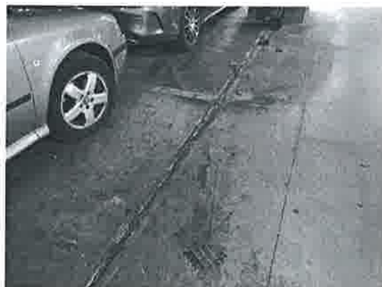
Estado del suelo y juntas de dilatación
