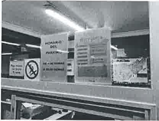
Estado de la carpintería de la garita
