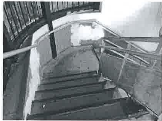
Estado de las escaleras y barandilla
