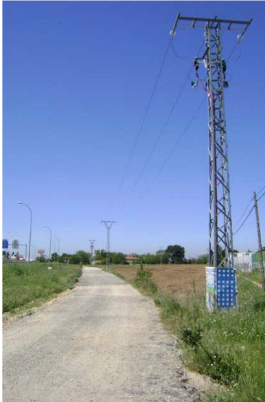
Imagen 15. Vista de una nueva línea eléctrica que discurre hacia el oeste dentro de la zona de estudio.
