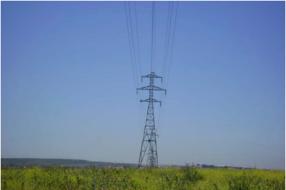
Imagen 21. Detalle de uno de los postes perteneciente a la línea de Alta Tensión que discurre al norte por fuera de la zona de Estudio.
