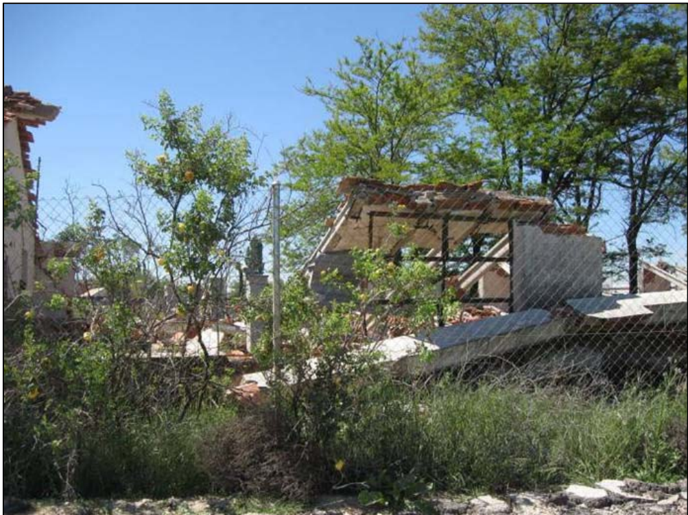
Imagen 30. Instalación en ruinas en la parcela catastral 58 del polígono 012.
