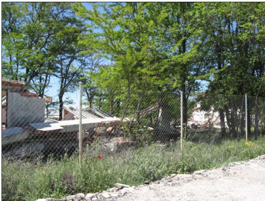
Figura 2.7.m. Detalle de las instalaciones en ruinas en la parcela n° 58
