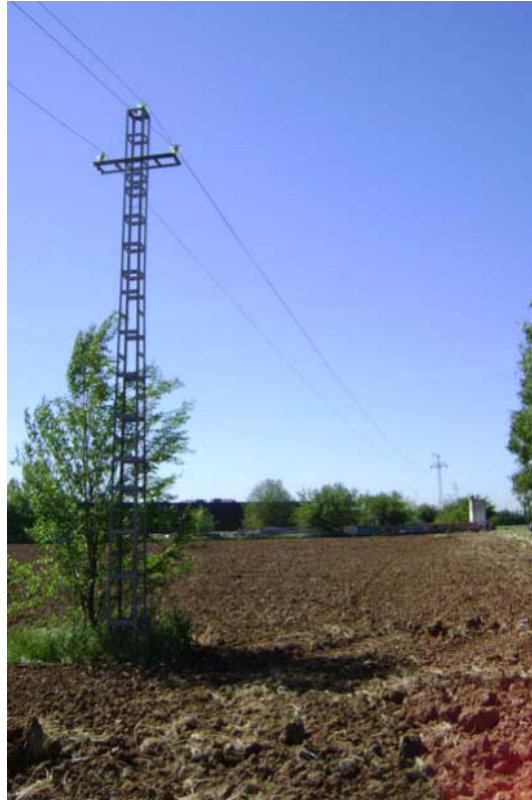
Imagen 5. Detalle de una torre eléctrica de baja-media tensión que discurre dentro del Sector.
