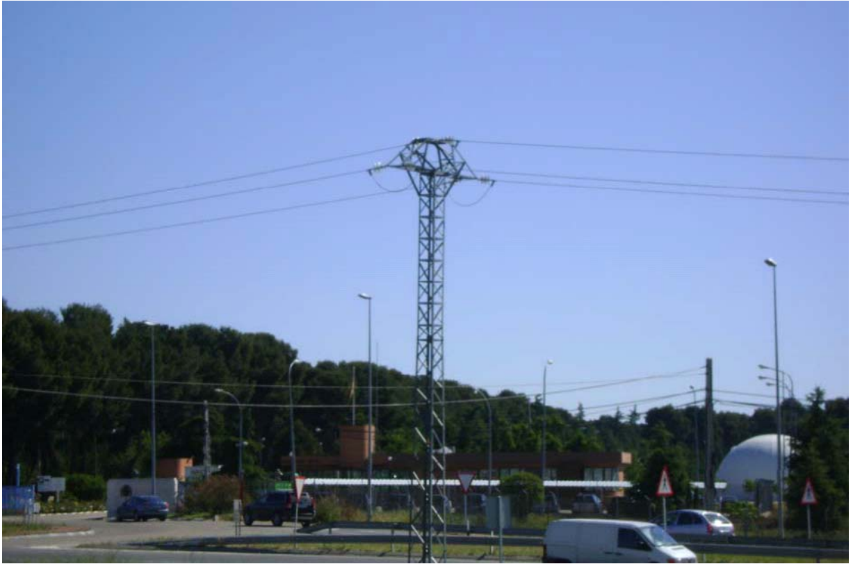
Imagen 1. Vista de una línea eléctrica de media-baja tensión que discurre en los límites de actuación de la parcela, en la carretera M-108.
