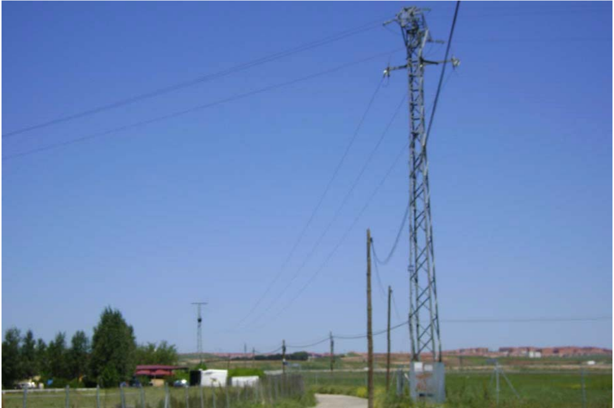
Imagen 17. Detalle de un poste eléctrico del que se derivan pequeñas líneas que abastecen a las diversas edificaciones cercanas.
