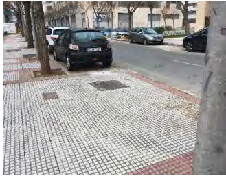
Arquetas de Telecomunicaciones-
